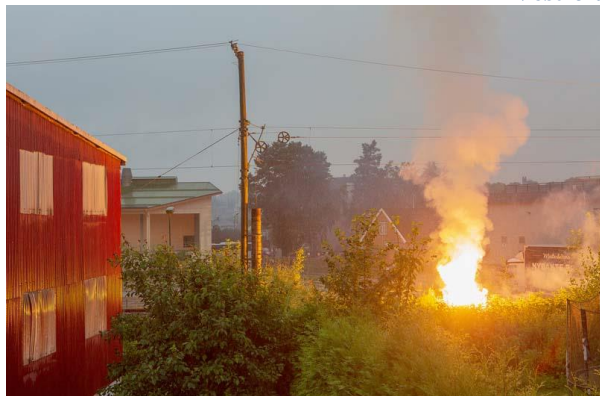
27.7. Det oppsto brann i forbigangsledningen ved kilometer 140 ved Sandefjord stasjon som resulterte i store skader på signalanlegget. 16000 volt i fri dressur i mer enn 10 minutter satte sine spor.
