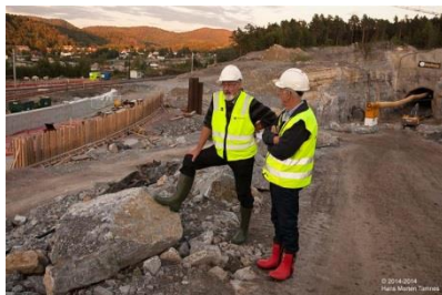
Jan Einar Larsen og Bjørn Holhjem. T.v. eksisterende bane og ny bro for Bjørntvedt sidespor, t.h. påhugget for Eidanger tunnel.
