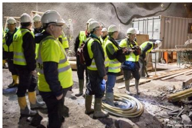
Torstein Reiersen og resten av følget ser med store øyne på dimensjonene. To år senere skal det gå tog her.
