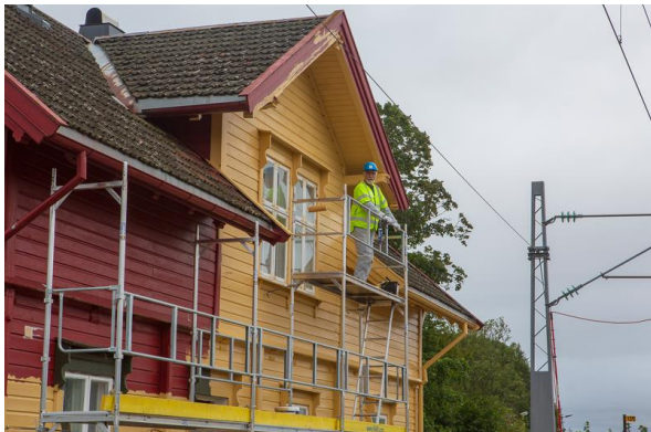
7.-9.9. «Ta guldfargen tilbake!» i samarbeid med SRS ble en suksess. I totalbruddet 7.-9.9. ble fasadene mot sporet malt. En fornøyd prosjektleder Øystein Wiik troner på toppen av stillaset på formiddagen 8. september. Da september var omme, var 2/3 av veggene på stasjonsbygningen og godshuset gule.
