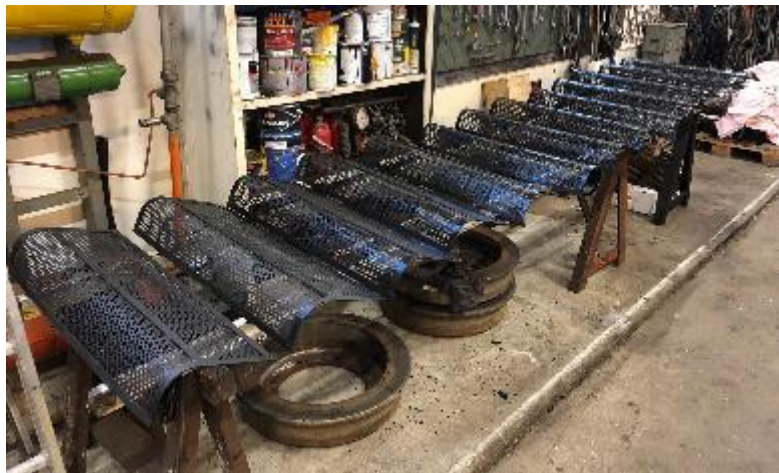
Rister over varmeelementene langs ytterveggene. Foto: Henrik B. Backer
