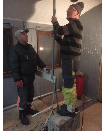
Montering av støtte mellom seterygg og tak i Co4a 195. Foto: Henrik B. Backer
