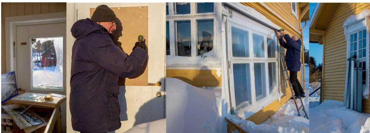
15. januar oppdaget lokalavdelingens leder at vinduet i døren til stasjonsmesterens kontor var knust. Rolf Burud stilte på kort varsel opp og hjalp til med en midlertidig reparasjon. Tre dager senere, 18. januar, var det vinduet til kontoret og en rute i godshuset som hadde gitt tapt for snø- og isklumper. Igjen var det Rolf som bisto, denne gangen ble plastglasset til kontorvinduet satt på. Vinduet i godshuset ble provisorisk sikret med ståldeler fra kornørke.
