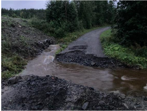
Gråbekken i Tarmen. Den forårsaket som kjent en stor jernbaneulykke i 1907. Kulverten under jernbanen ble utbedret for noen år siden, men rørene som gikk under lokalveien hadde ikke kapasitet til å ta unna de store vannmassene som kom under uværet «Hans» Det måtte tas hull på veien for å føre vannet unna. Foto: Asbjørnhus
