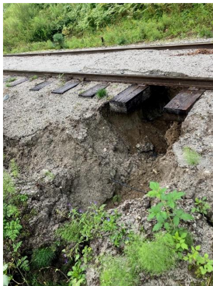
Uværet «Hans» vasket ut sporet ved km ca. 112. Dette ble raskt utbedret slik at togene gikk som normalt igjen helgen etter. Foto: banemester Asbjørnhus
